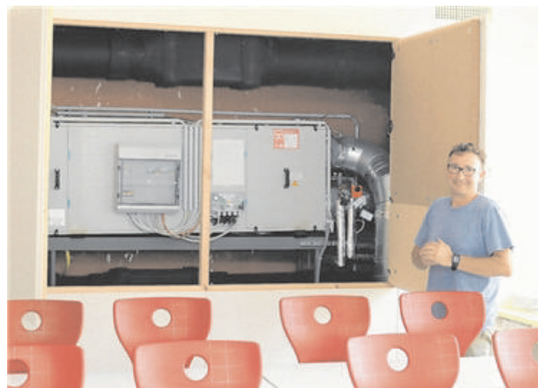
▲ Corona-Prävention beginnt bei sauberer Luft. In der Mittelschule Ybbsitz sind alle Klassen mit kontrollierter Wohnraumlüftung ausgestattet, die laufend die mit Aerosolen belastete Atemluft gegen reine Frischluft austauscht und dabei klimafreundlich die Wärme rückgewinnt. Schulwart Klaus Lindner überprüft die Funktion regelmäßig.
